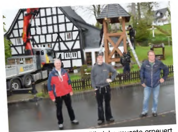
Der Glockenturm in Möllmicke musste erneuert werden. Wir sehen v.l.n.r. die Zimmermeister Peter und Tim Häner sowie Ortsvorsteher Detlef Breidebach.
